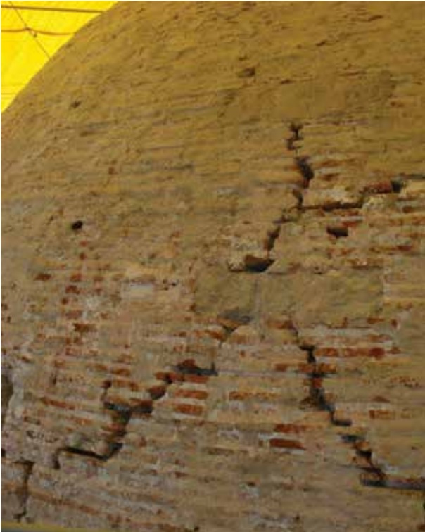
Cami kubbesinde meydana gelen diagonal çatlaklar
