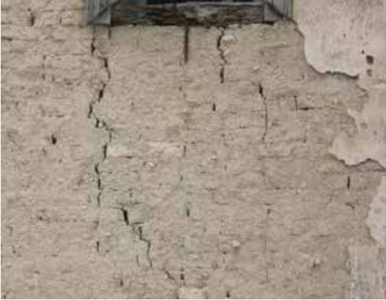
Düşey ve diyagonal çatlaklar
