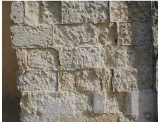
Duvarda süngersi bozulma
