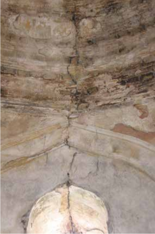
Hamam duvarında farklı oturmalarından kaynaklanan çatlak
