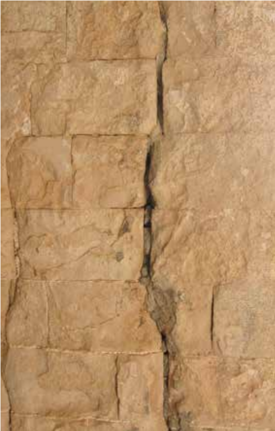
Duvar yüzeyinde meydana gelen çatlak
