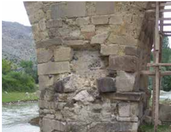
Köprü ayaklarında meydana gelen boşluklar
