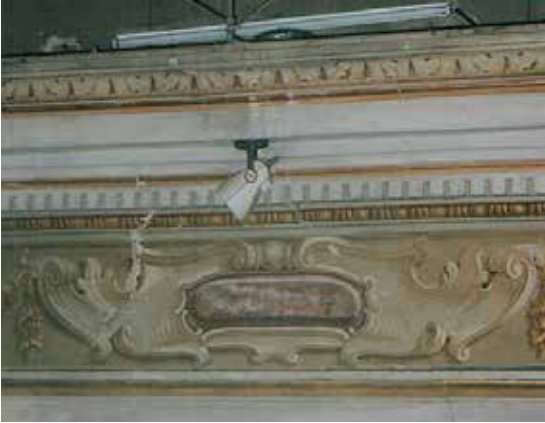
Deprem sonucu oluşmuş diyagonal çatlaklar
