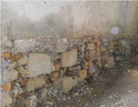
Duvar malzemesinde birleşme hataları
