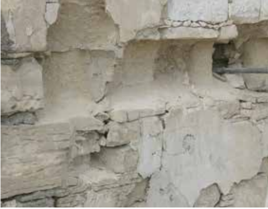
Duvarda yerel boşluklar
