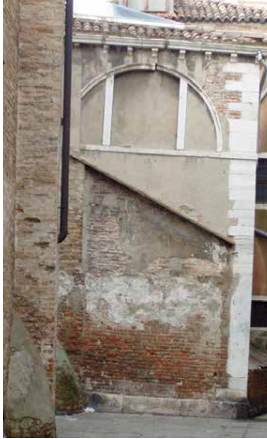
Zayıf zemin nedeni ile binanın dönmesi
