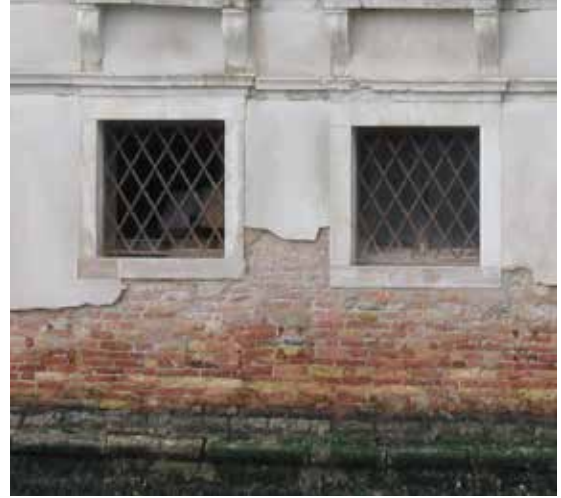
Nemin duvar içerisinde yükselmesi
