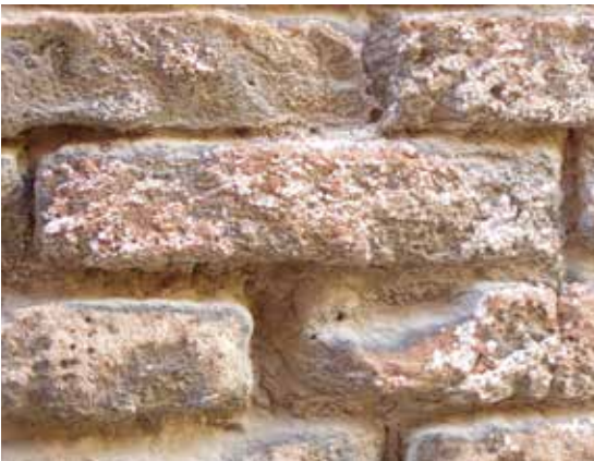
Derzlerin zaman içerisinde boşalması
