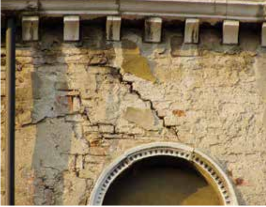
Duvar yüzeyinde diyagonal çatlaklar
