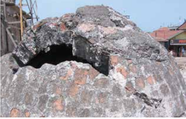
Küçük kubbede meydana gelen kısmi göçme
