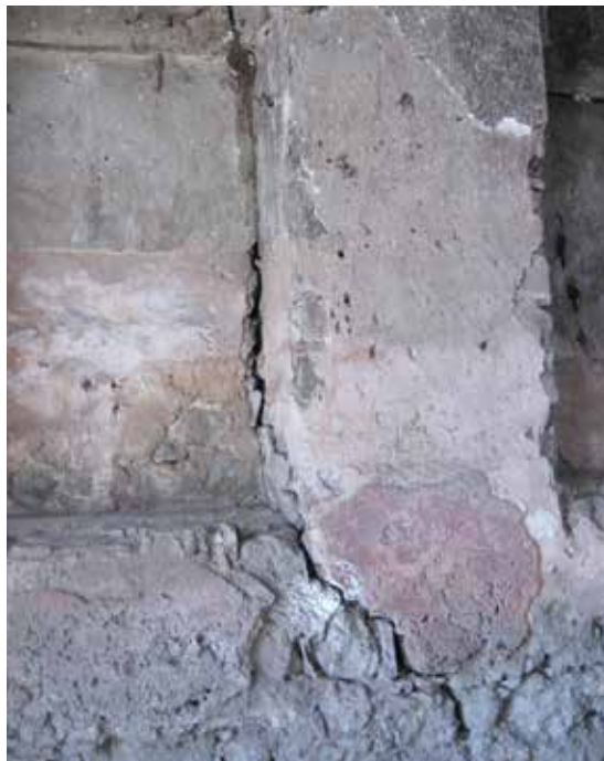
Oturmalara bağlı olarak oluşan çatlaklar
