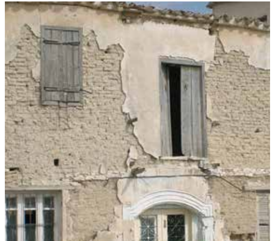
Sivada meydana gelen dökülmeler
