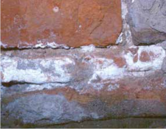
Tuğla yüzeyinde tuz kusması (çiçeklerime)
